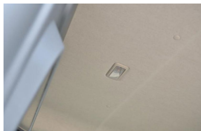
Dachhimmel mit Beleuchtung
